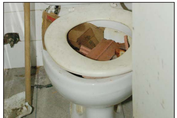
INACEITÁVEL. Privada interdita no alojamento
