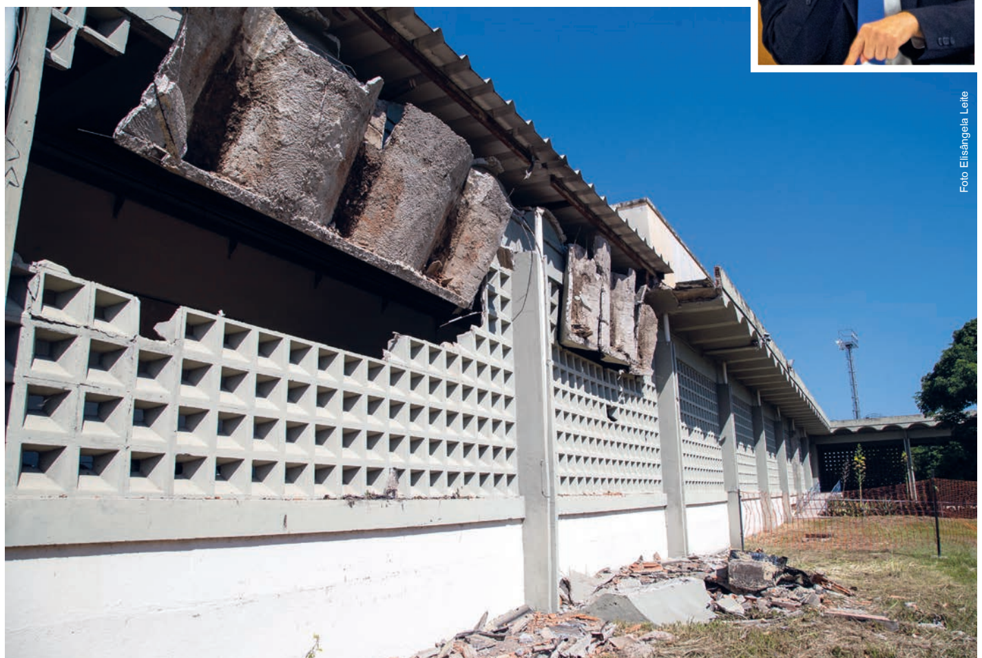
A MARQUISE DA ESCOLA DE EDUCAÇÃO FÍSICA desabou: retrato que simboliza as condições físicas precárias da universidade. No detalhe, o reitor Roberto Medronho, que na opinião de Gambine tem atuação tímida diante da crise
