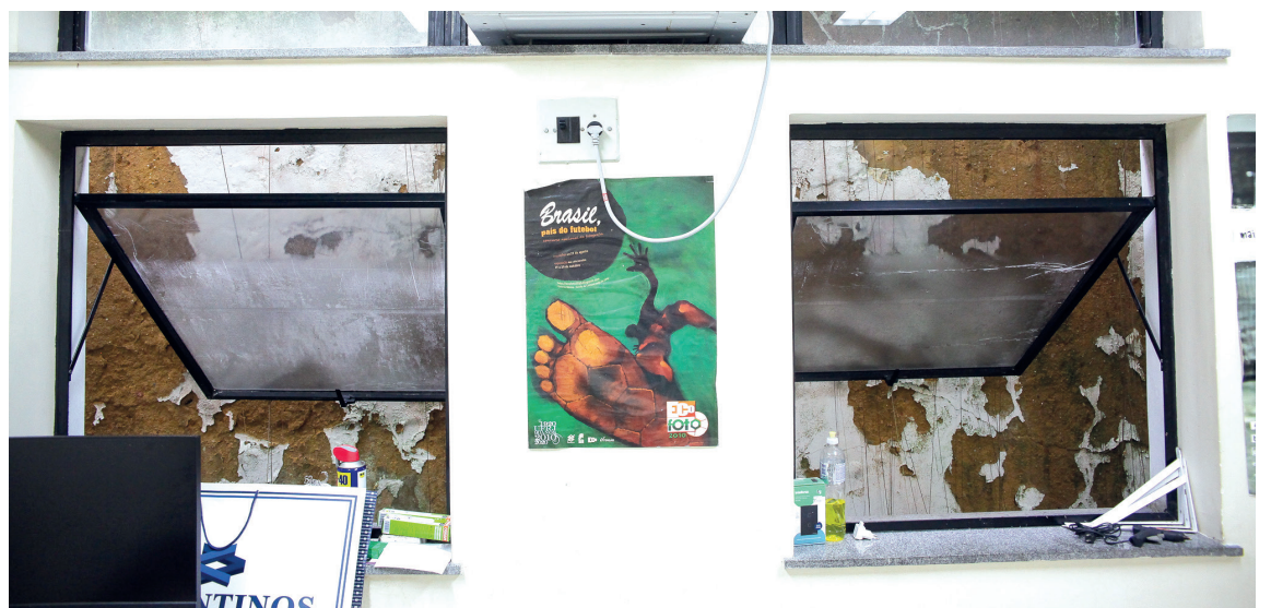
PAREDE DESCASCADA ao lado da sala da Coordenação cujo ar-condicionado puxa o ar contaminado, de acordo com servidores
